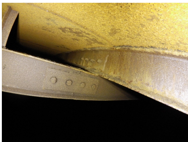
天井のボルト
